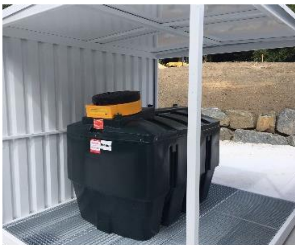
Figure 9 : Exemple de protection de la cuve à huile minérale avec rétention équivalente au volume de la cuve
